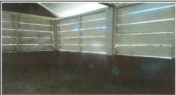
Foto 3: Las paredes de la cocina están hechas de tabla, con separaciones entre cada una. Es necesario elevar la pared utilizando bloques para mejorar la seguridad.
