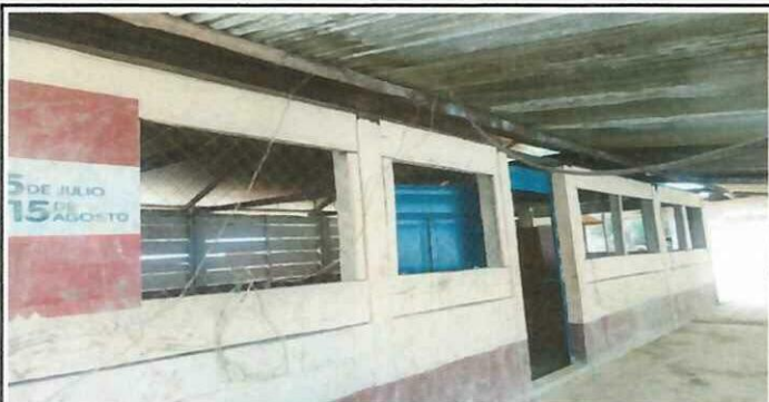
Foto 5: Las ventanas de la cocina están deterioradas y ofrecen poca seguridad.
