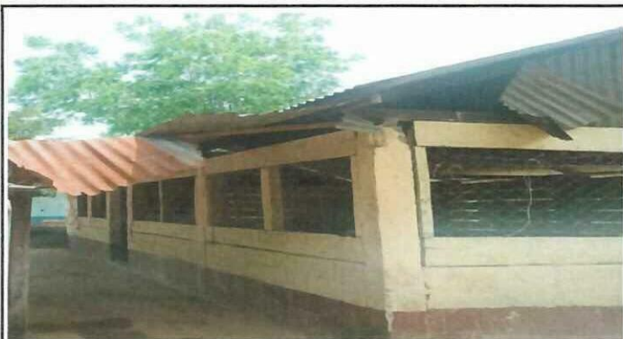
Foto 1: La cubierta de lámina de la cocina presenta deterioro, lo que permite la filtración de agua durante el invierno.
