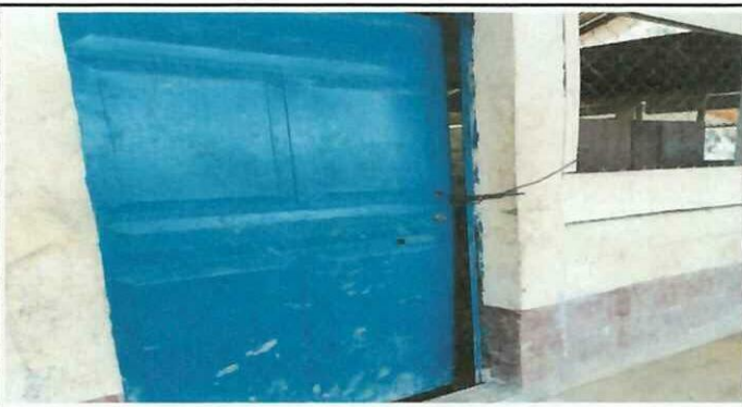
Foto 4: Las puertas de la cocina están en mal estado, por lo que se requiere su reemplazo para mayor seguridad.
