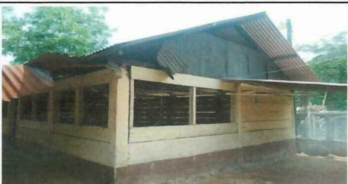
Foto 6: La pintura de la cocina está deteriorada
