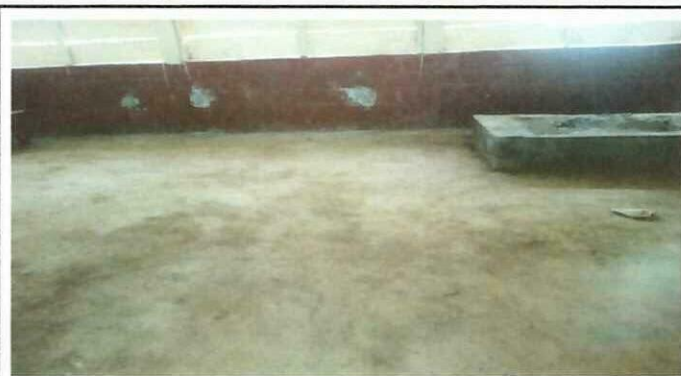
Foto 2: El piso de la cocina presenta un desnivel que afecta la estabilidad al estar de pie.
